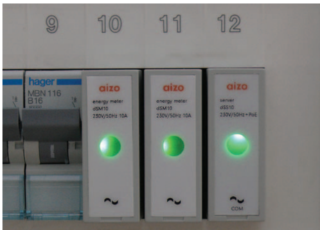
Bild 6 Digitalstrom-Server und Digitalstrom-Meter im DIN-Verteilergehäuse – pro Stromkreis wird ein dS-Meter benötigt
