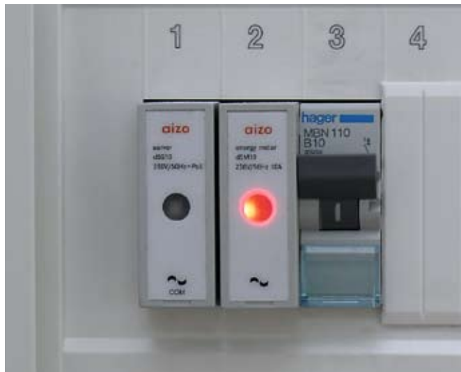
Ergänzen die Digitalstrom-Installation: Der Webserver und der Meter.
