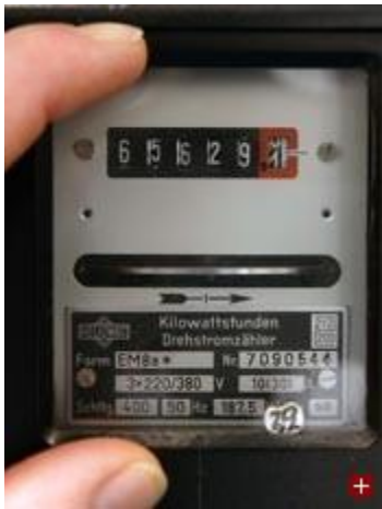
Gehört schon bald zum alten Eisen: Der schwarze Stromzähler
